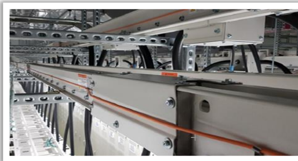
[빌딩·공장 부스덕트 온도 감시]
